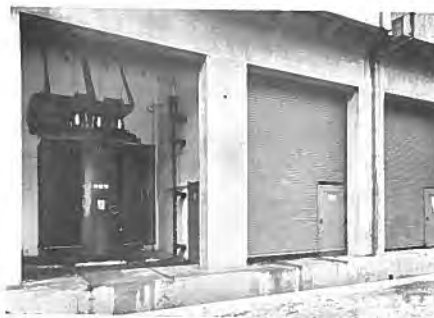
第 1 圖 主變壓器室
