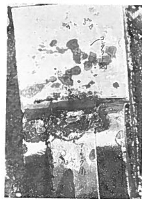
第 14 圖 油入遮断器上部接觸部 デアイオン・グリッド無し
