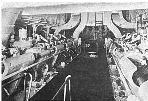
第 4 圖 主配電盤上部機關室
