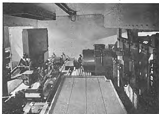
第6圖 55 吨電氣機關車第二エンド高壓室
