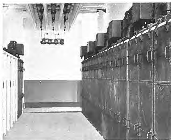
第 8 圖 變電所二階にある OE-6 型油入遮斷器
