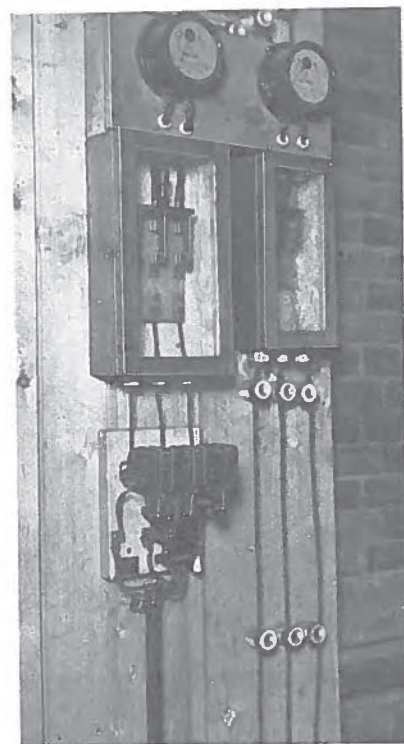
第 六 圖 壁掛電熱器の取付状態
