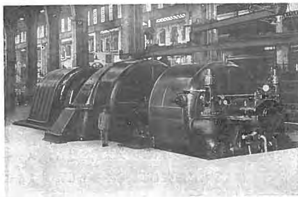
第 一 圖 工場内タービン外形
