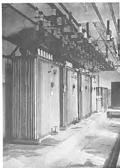
第五圖 小田原急行經堂變電所 Transformer Bank
